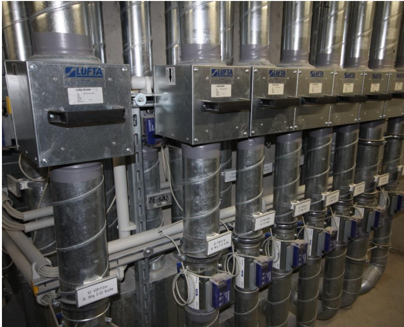
Trotz Lüftungsanlage in jeder Wohnung liegt auch der Stromverbrauch in der Bahnstadt deutlich unter dem Durchschnitt. Foto: Passivhaus Institut
