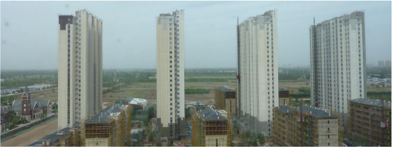
Die Baustelle aus anderer Perspektive. Nach Fertigstellung ist die Bahnstadt Gaobeidian die weltweit größte Passivhaus-Siedlung. Zur 23. Internationalen Passivhaustagung können die Wohnungen besichtigt werden. © Passivhaus Institut
