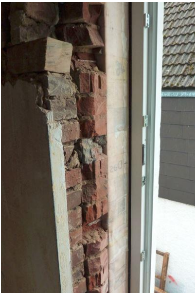
Die neuen Fenster und Türen sind dreifach verglast. Die Laibungen sind mittlerweile wohnlich gestaltet. © Passivhaus Institut
