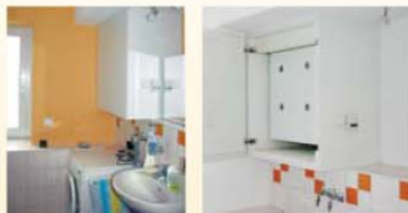
Dezentrale Lüftungsanlage im Bad
